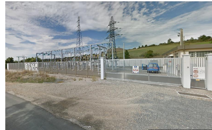
Exemple d'un poste source, celui de Mende en Lozère (Google Street View)
