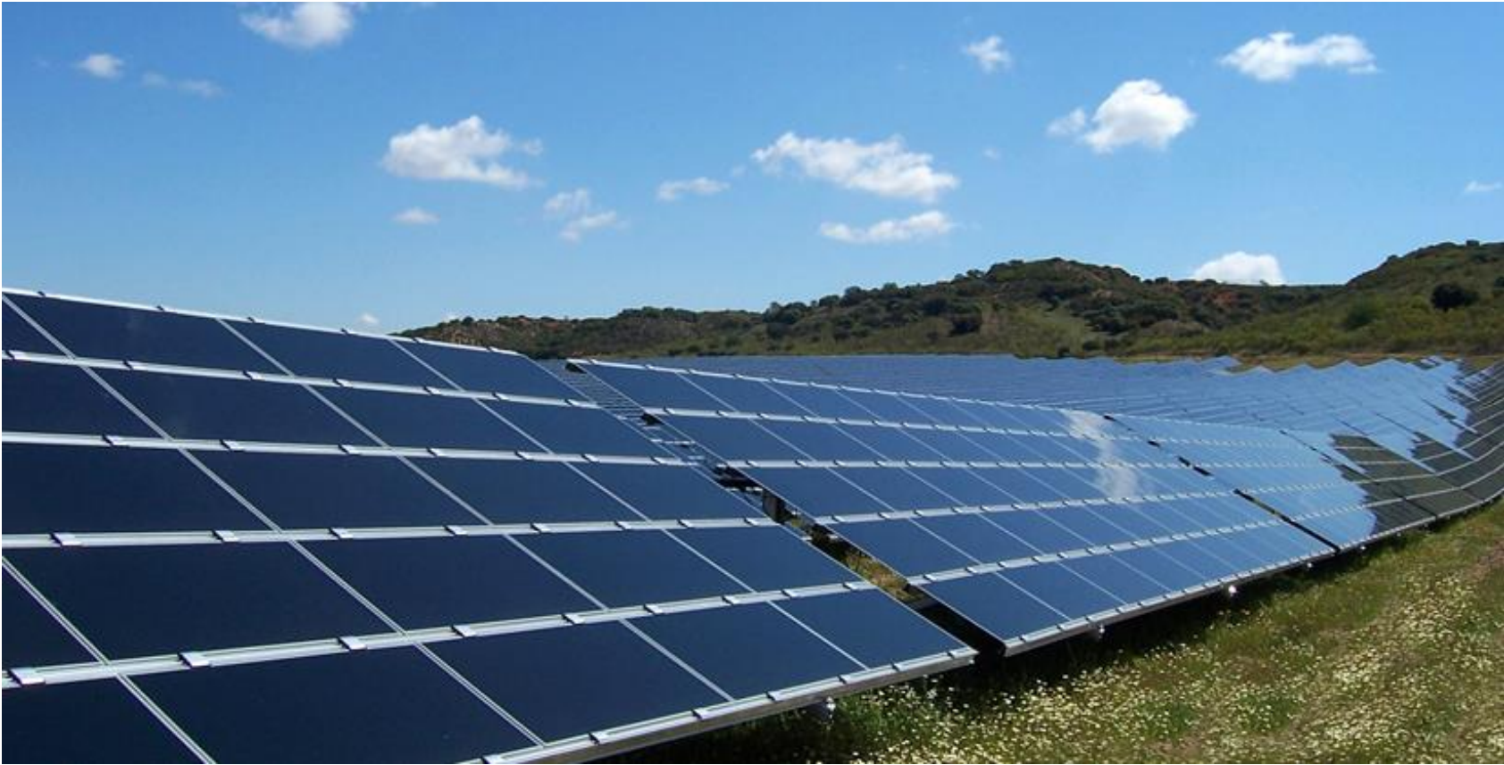
Parc photovoltaïque EDF power solutions de Narbonne
